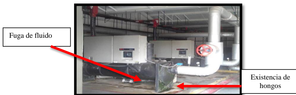
Figura 3 Condición física de los equipos Chillers Fuente: Elaboración Propia (2019)
