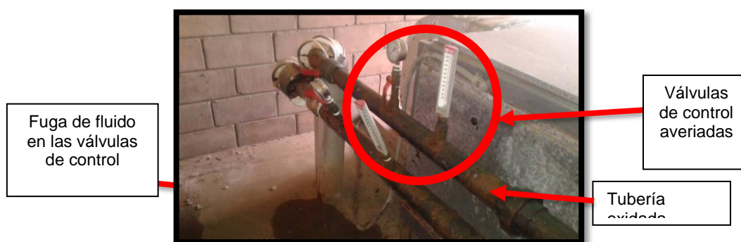
Figura 4. Condición física de los equipos Chillers Fuente: Elaboración Propia (2019)
